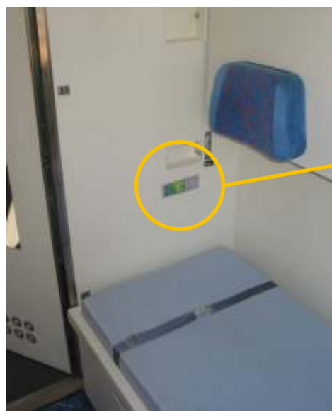
PULPIT STEROWNICZY Z OBSŁUG O WIETLENIA ZAMONTOWANY W PRZEDZIALE SYPIALNIANYM
